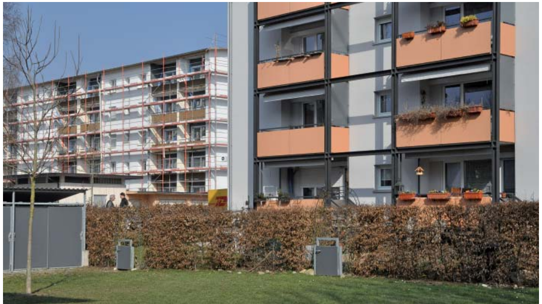
Der größte Teil der Arbeit ist getan – im Bild rechts Wohnungen der Häuser Kolpingstraße 17-19 mit den neuen Balkonen und Buchenhecken vor den Mietergärten. Noch bis in den Frühsommer hinein sind Handwerker im Quartier und sanieren die Häuserreihe Kolpingstraße 20-24 (links im Bild).
